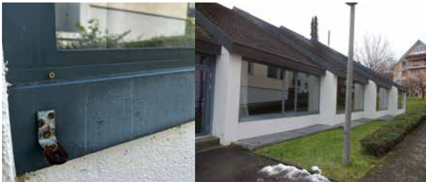
Bild 3: Die Fenster des Gemeindsaals weisen durch ihre Bauweise einen schlechten Wärmedurchgangskoeffizient auf.
