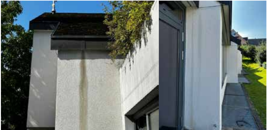
Bild 2: Die Fassade ist zu wenig oder teils gar nicht isoliert.
